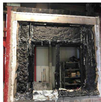
O ensaio termina quando a integridade se perde e a caixilharia cede. O lado exposto ao fogo pode ser visto como carbonizado e fundido.
